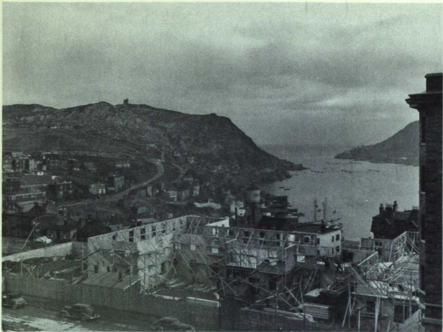
Construction des quartiers généraux de la MRC à St. John's. À l'arrière-plan on aperçoit les filets anti-torpilles. Novembre 1941.
