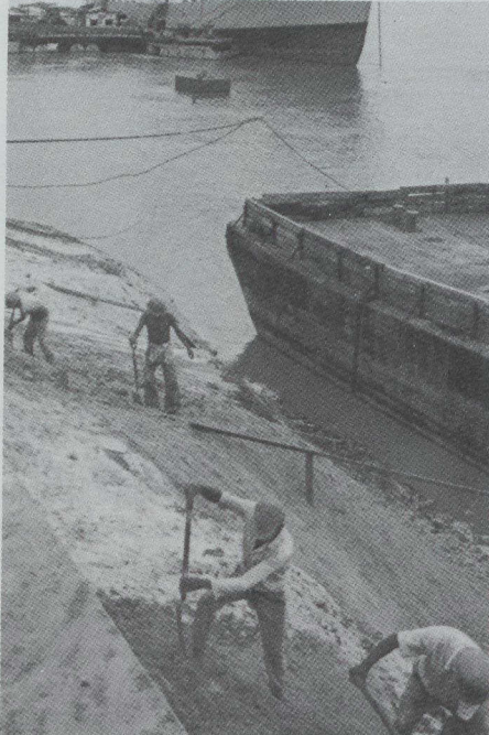
Construcción de terminales fluviales e instalaciones para manejo de carga en la cuenca del Río Amazonas, en Perú.
