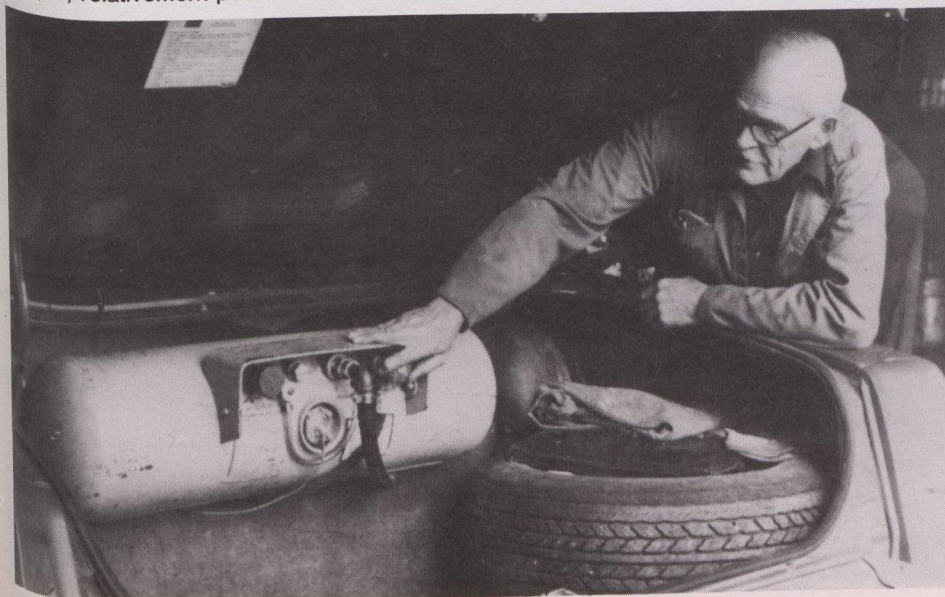
Le réservoir de propane est installé, dans ce cas, à l'intérieur du coffre de la voiture.
