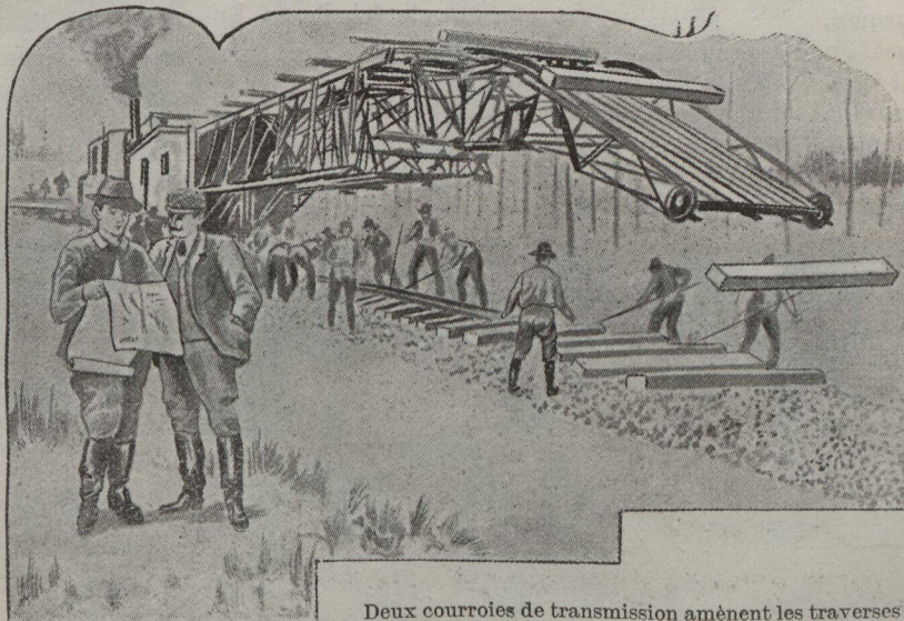
Deux courroies de transmission amènent les traverses
