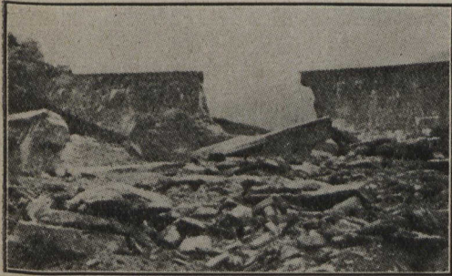
Vue de l'endroit où le barrage s'est rompu
