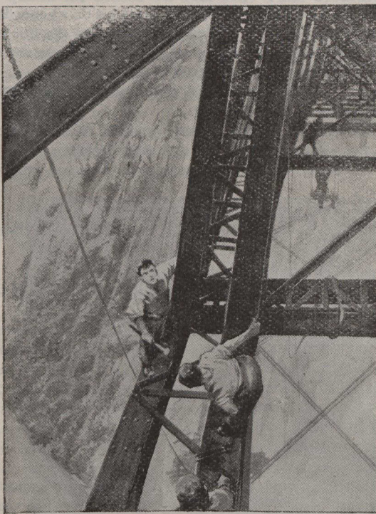
Ouvriers travaillant à la construction du pont métallique au-dessus des chutes Victoria en Afrique.
