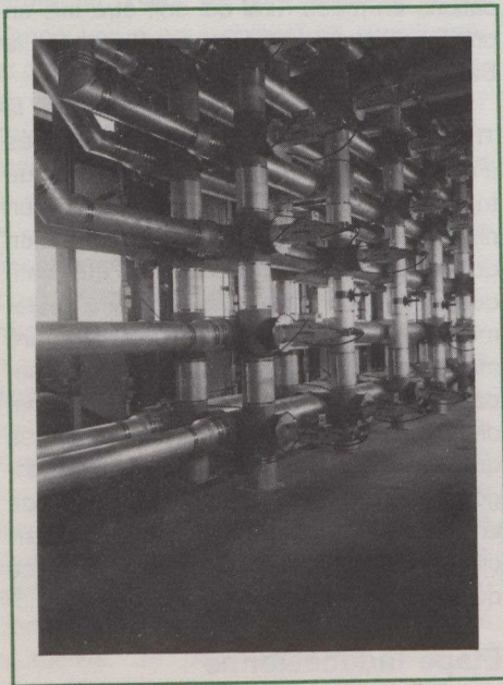
Grille matricielle reliant les diverses antennes aux huit émetteurs de la station émettrice de Sackville (Nouveau-Brunswick).
