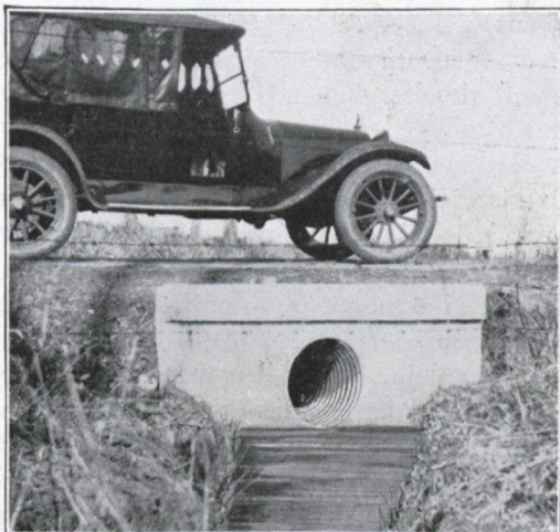
Ponceau en fer cannelé, en usage pour drainer un chemin en brique dans le Missouri
