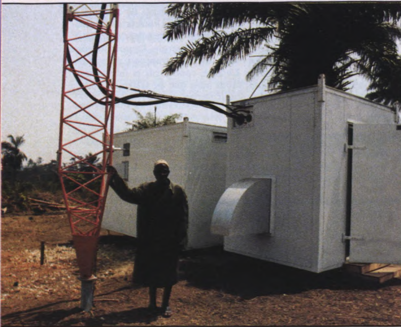
▲ INTELCAN Technosystems Inc. d'Ottawa a fourni des systèmes hyperfréquences clés en main à divers pays d'Afrique occidentale. Nous voyons ici une installation de répéteur à distance au Sierra Leone, qui fait partie d'un réseau hyperfréquence de 800 km reliant ce pays à la Guinée et au Libéria.
