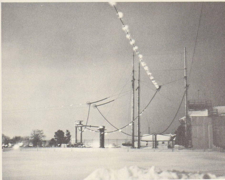
La photographie à longue durée d'exposition permet de mettre en évidence les effluves de l'effet de couronne que l'on voit ici dans le cas d'un conducteur positif parcouru par un courant continu à la Station d'essais des hautes tensions du CNRC, à Ottawa.
