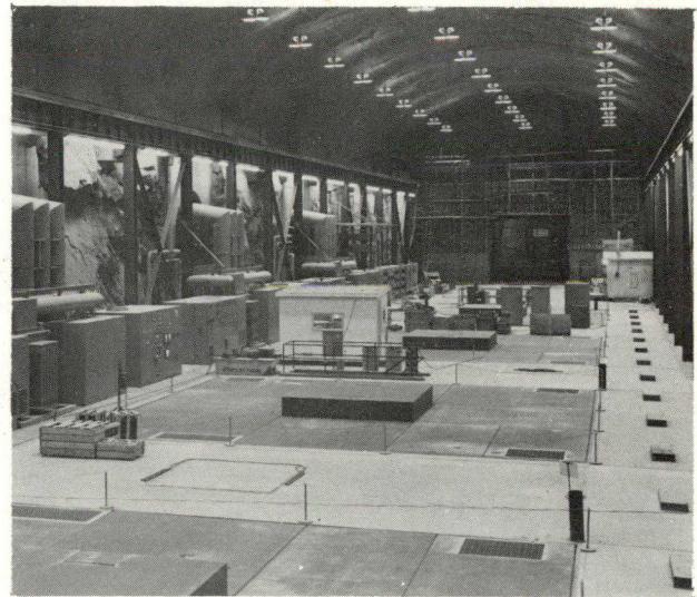
La salle des machines d'Outardes 3.
