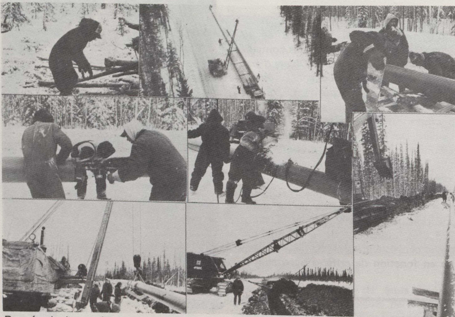
Rangée du haut, de gauche à droite : nettoyage de l'emprise du pipe-line de Norman Wells près de Wrigley. — Alignement des canalisations le long de l'emprise. — Des matriers soutiennent les canalisations avant qu'on les aligne pour les souder. Deuxième rangée, de gauche à droite : alignement des canalisations avant le soudage. — Soudage des canalisations. — Pelle rétrocaveuse mécanique creusant la tranchée du pipe-line. Rangée du bas, de gauche à droite) : mise en place des canalisations dans la tranchée. — Grue équipée d'un dispositif permettant d'enfourer le pipe-line de Norman Wells.
