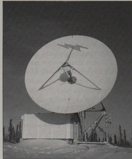
Antenne de télécommunication
