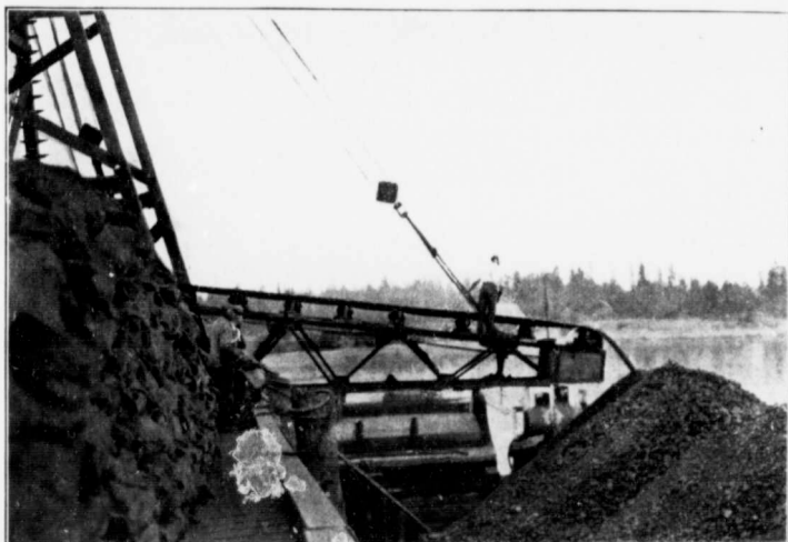
CHARGEMENT D'UN BAC PAR COURROIE TRANSPORTEUSE, PACIFIC COAST COAL CO., BOAT HARBOUR, I.V.
