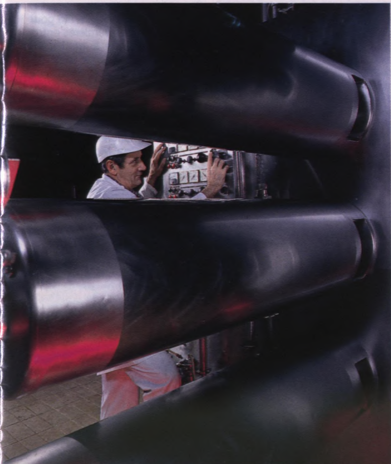
Équipement du procédé de traitement des eaux usées (résidus de fabrication des fromages et eaux de lavage) (Coopérative agro-alimentaire Agropur)
