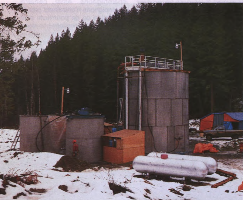
Le plus gros réacteur de biolixiviation au monde. Le réservoir a 6,5 mètres de diamètre et 7,2 mètres de hauteur. Ce réacteur est situé près de Goldbridge, en Colombie-Britannique
