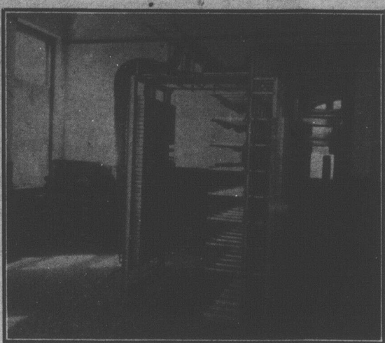
On voit ici ce que la compagnie appelle le "terminal room". Elle contient une partie très importante de l'équipement que l'on voit au centre.
