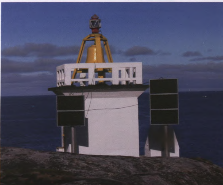
Les panneaux solaires offrent une source durable d'énergie de remplacement pour les phares autrefois alimentés par des matières hautement radioactives
