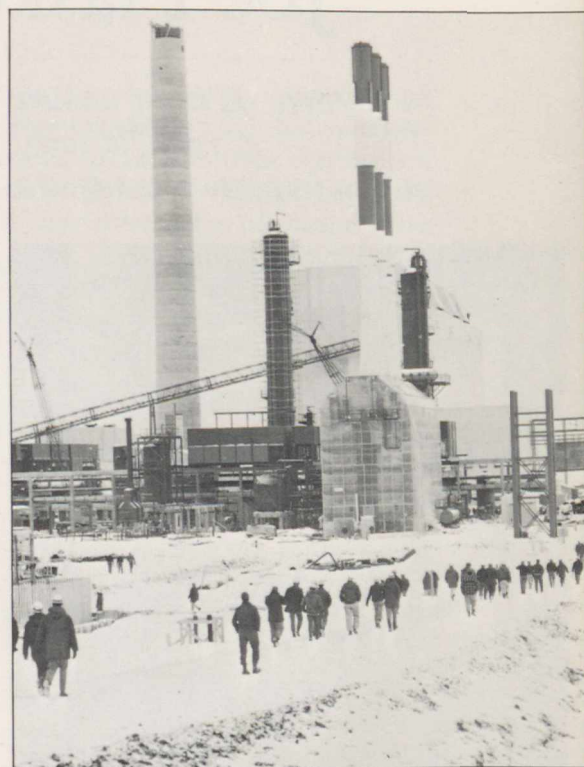
Le pré-raffinage des sables bitumineux exige des installations imposantes à proximité du gisement.
