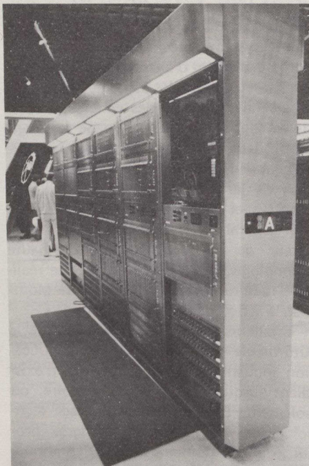
Un autocommutateur numérique DMS-100 de Northern Telecom.
