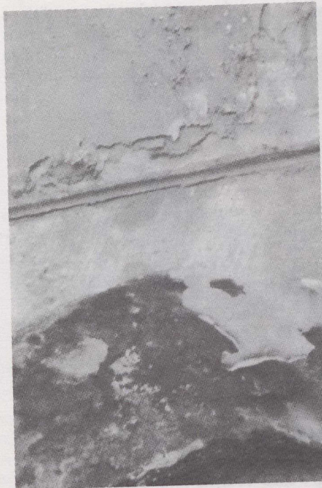
Le lessivage répété par les pluies acides finit par ronger la surface des automobiles, des édifices, des monuments funéraires et d'œuvres d'art sculptées dans la pierre. Des structures architecturales telles que les édifices du Parlement, à Ottawa, ont déjà subi des atteintes.
