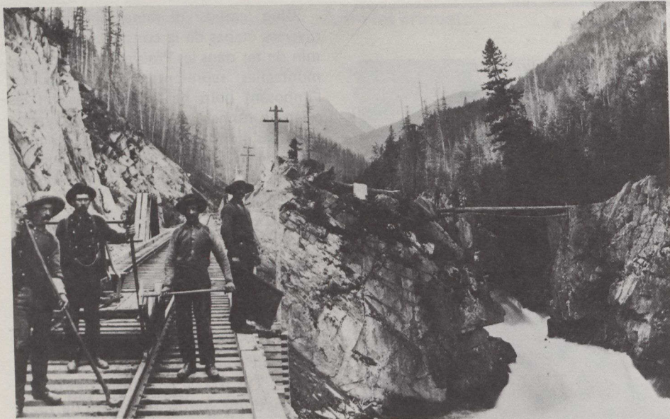
Une équipe répare une section de la voie longeant le canyon de la rivière Beaver, en Colombie-Britannique.
